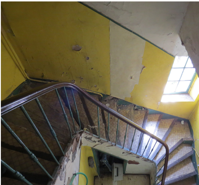
L'ÉTAT DE L'ESCALIER INTÉRIEUR
