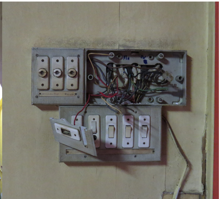
L'ÉTAT DE L'ÉLECTRICITÉ
