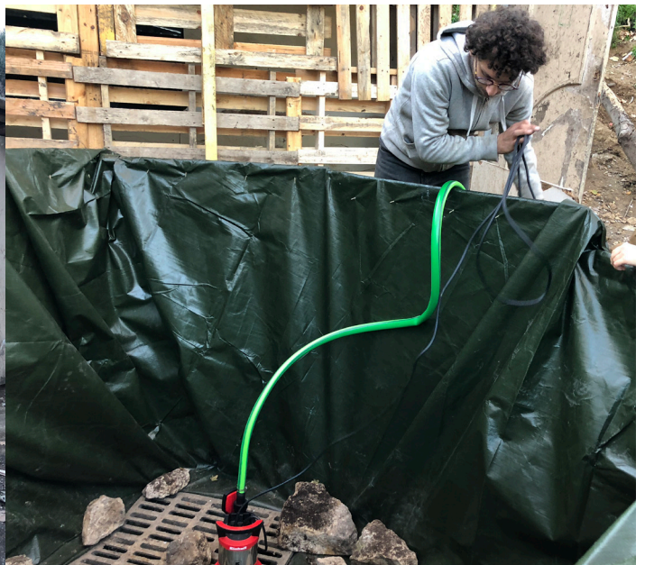
LA POMPE DANS LE BASSIN
